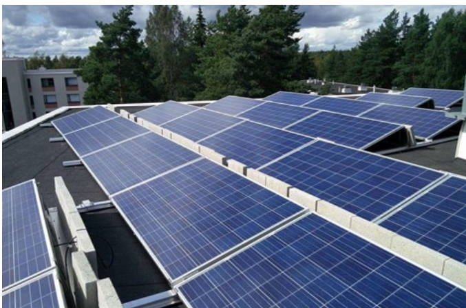
Elokuussa Helsinkiin asennettiin Suomen toistaiseksi suurin aurinkovoimala kerrostaloon. Aloite aurinkovoimalasta tuli osakkaalta. Nyt paneeli tuottaa sähköä 11 talon käyttöön.
